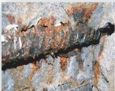
Insuffisance de l'enrobage engendrant la corrosion des aciers Art 2.2.4 DTR BE 2.1
