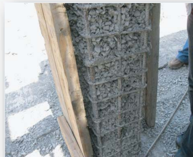
Coffrage non étanche-fuites de laitance Art 2.1 DTR BE 2.1
